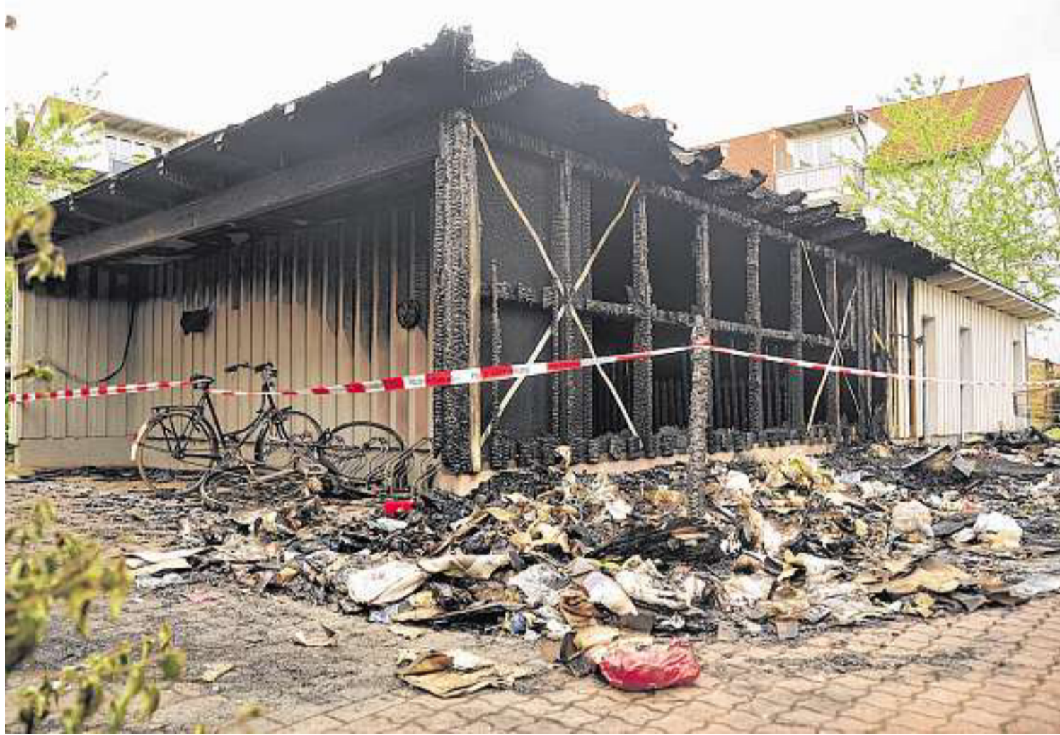
Der nun völlig ausgebrannte Müllunterstand war nach dem damaligen Großbrand auf dem Areal weiter von den Wohngebäuden entfernt errichtet worden. Daher gelang es der Feuerwehr in der Nacht zu Dienstag, ein Übergreifen der Flammen vom Schuppen aufs Wohnhaus zu verhindern. FOTO: RAHN
